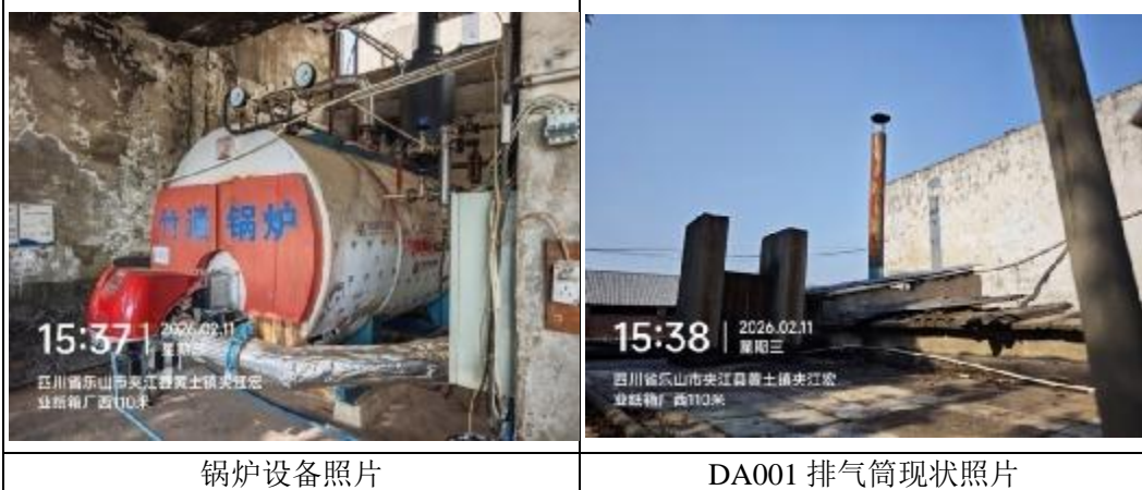
图 3.6-1 技改前项目锅炉设备及 DA001 排气筒照片
