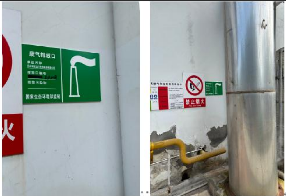
DA008.....DA008 废气治理设备
